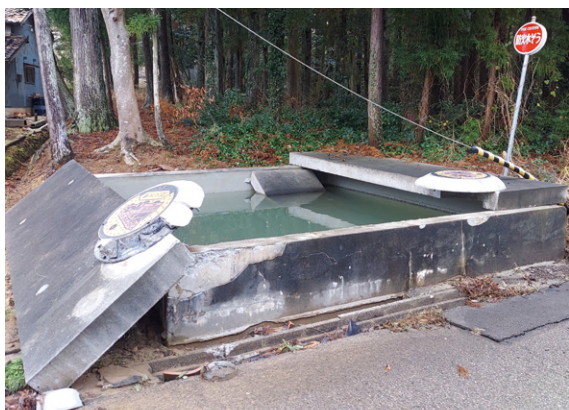
実家前防火水槽の蓋 地震によるズレ
