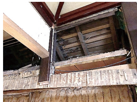
図-7 内壁聚楽塗り崩落
