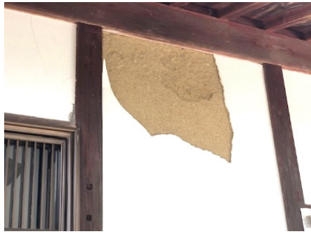
1階外壁:漆喰一部剥離落下、下地竹木舞
