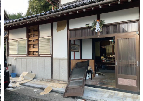
図-5 玄関4枚引違戸枠より外れる
