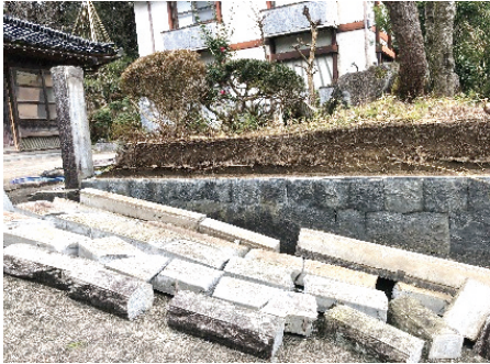
図-3 御影石塀崩落(凡て)
