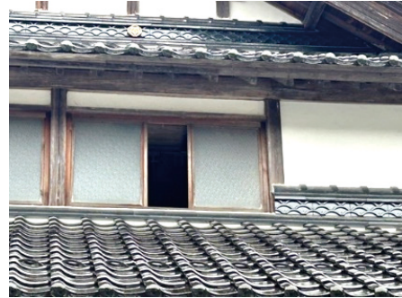
図-4 正面木製FIX内部床に落下
