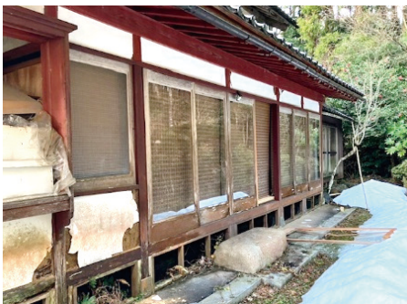
図-6 外部木製木建具1枚ガラス割れる
