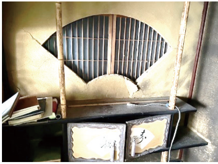
2階 和室8畳:壁 剥離
