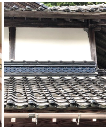
図-12 外壁漆喰塗剥離
